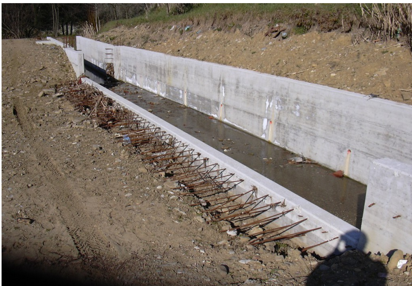
Fig. 34 - Cassa di laminazione in derivazione – particolare dello sfioratore laterale di alimentazione
